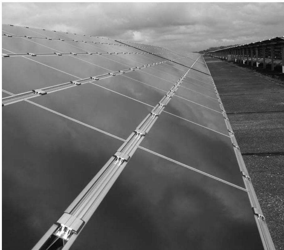
Abb. 1: Fertig montierte Reihe von Solarmodulen
